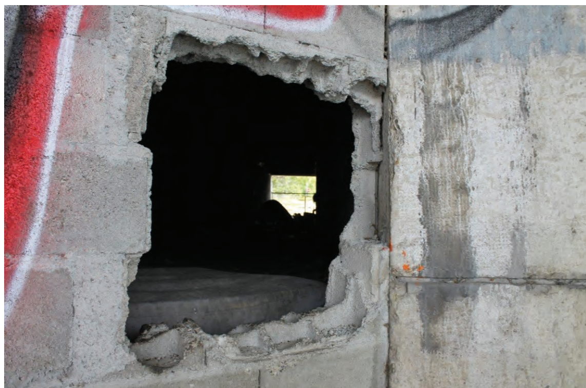
Un trou a été aménagé par les anciens occupants à l'arrière d'une cavité bâtie fermée côté ville par une épaisse grille en fer. Cette entrée de fortune est protégée de la pluie par le pont en surplomb et donne directement sur des escaliers permettant de remonter des berges vers les quais hauts.
